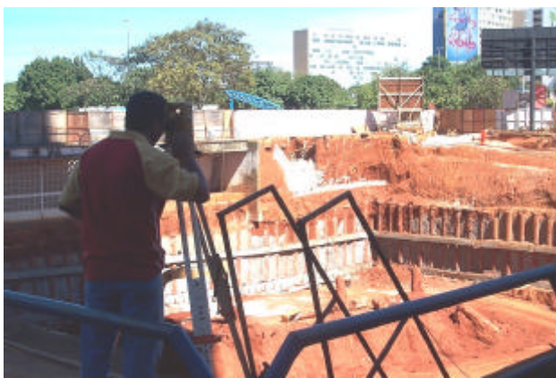
Figura 7. Medição dos deslocamentos do topo das estacas e das linhas de grampos, Obra no Setor Bancário Sul.
